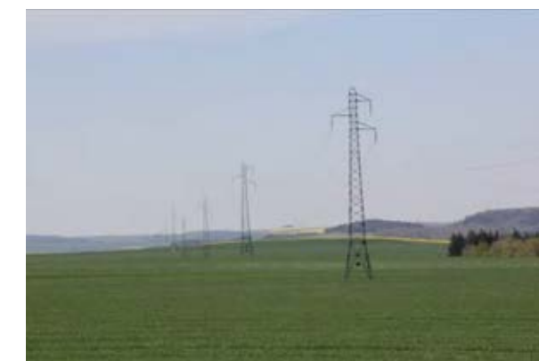
Photo 43 : Ligne électrique 63 kV traversant l'aire d'étude immédiate
