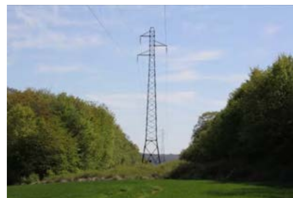
Photo 42 : Ligne électrique 63 kV au sud-est de l'aire d'étude immédiate
